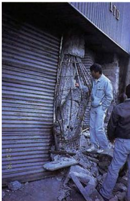
تصویر شماره 4 مسئله تخریب ستونهایی که در راستای عرضی بدرستی
